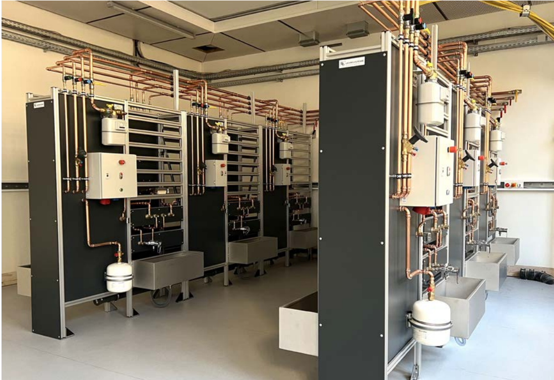
Gasversuchsraum: Arbeitsplätze zur Medienversorgung von Wärmeerzeugern (Gasbrennwertgeräte, Wärmepumpen)
