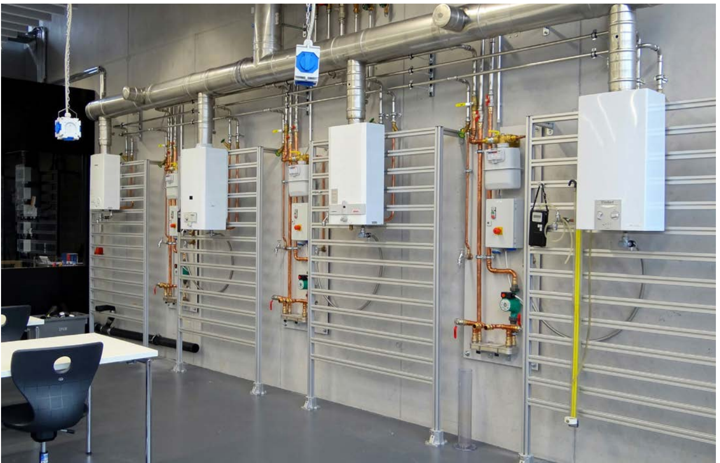
Wandarbeitsplätze mit Energiesäulen
