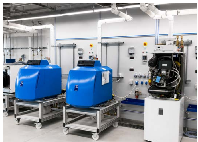
Standkessel an Ölgeräte-Versuchsstände
