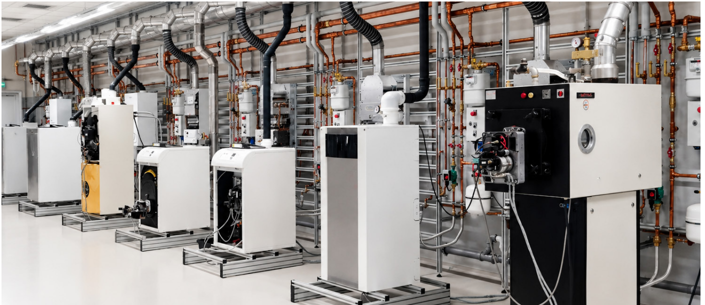
Fachraum für Öl- und Gasgeräteprüfung
