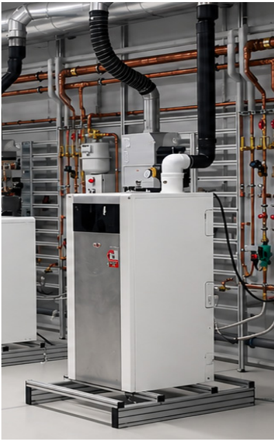
Kesselpodest für Standgeräte
