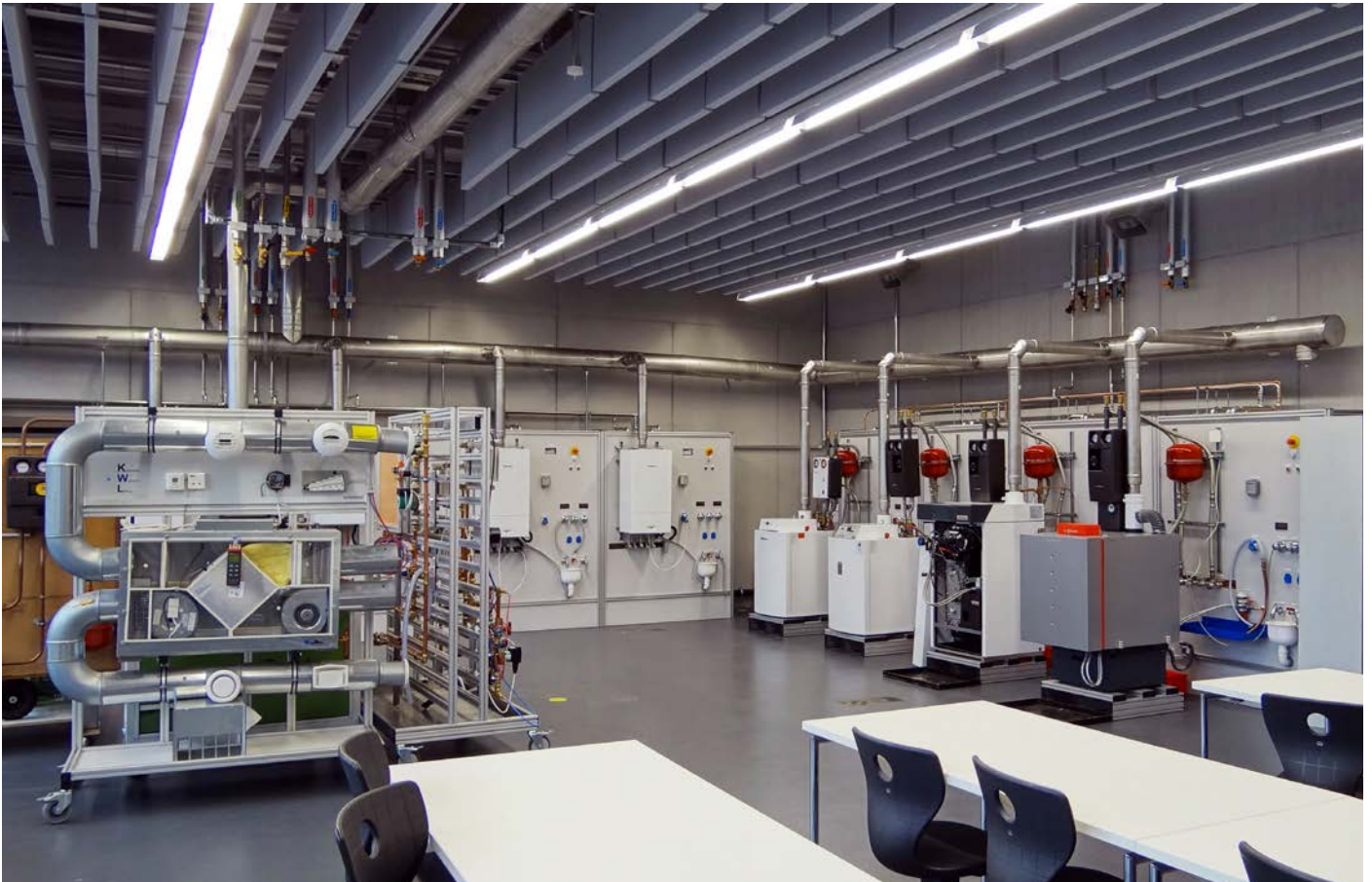
Fachraum für Öl- und Gasgeräteprüfung
