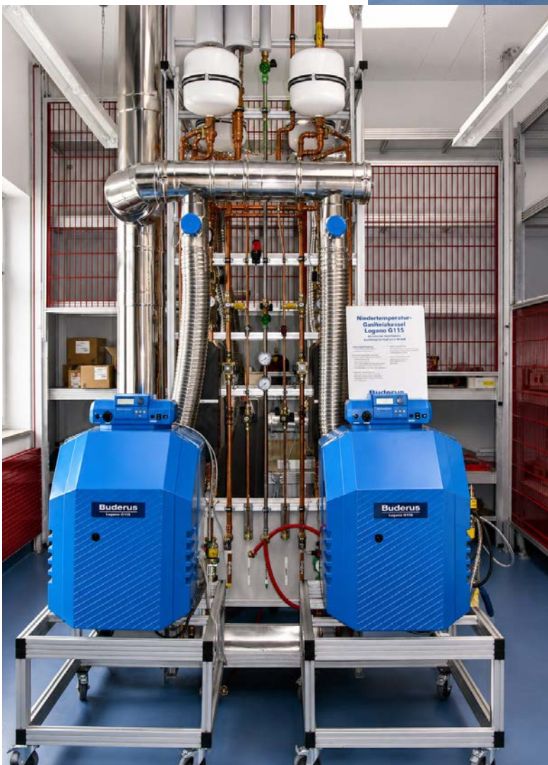
Energiesäule mit Kessel auf Podesten
