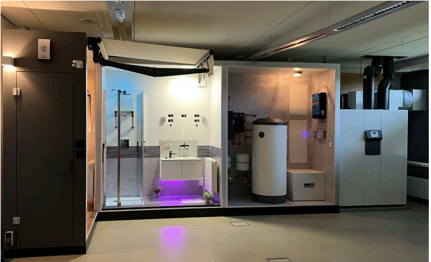
Schulungswand „Digitale Gebäudetechnik“ mit integriertem Armaturenprüfplatz im Badezimmer; die Gebäudeautomation ist mit Produkten der Firma Loxone realisiert.
