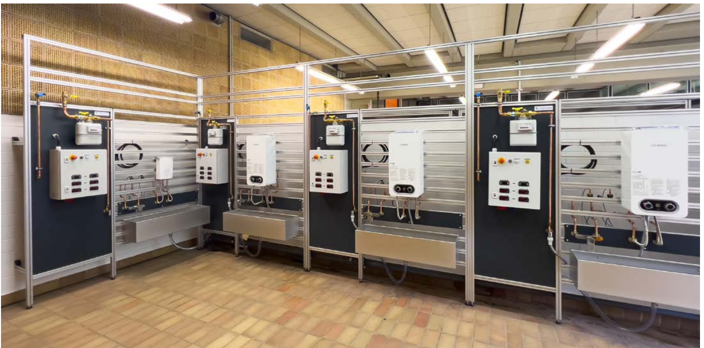
Beispiel einer Klassenrauminstallation. Prüfstände für Gas- und elektrische Durchlauferhitzer
